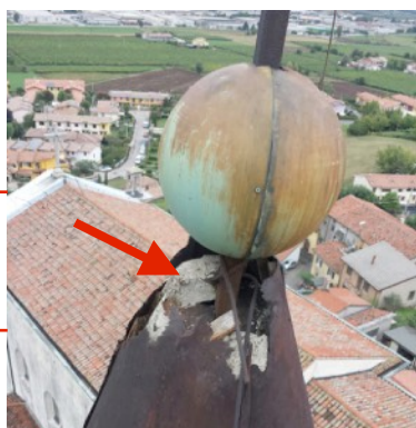
Cuspide del campanile danneggiata
