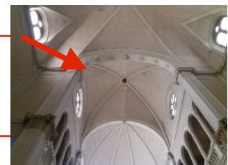
Infiltrazioni d'acqua nel tetto della chiesa
